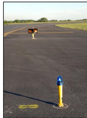
Balizas de Borde de rodaje y Semáforo
