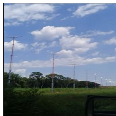
Mástiles Sistema de luces de aproximación
