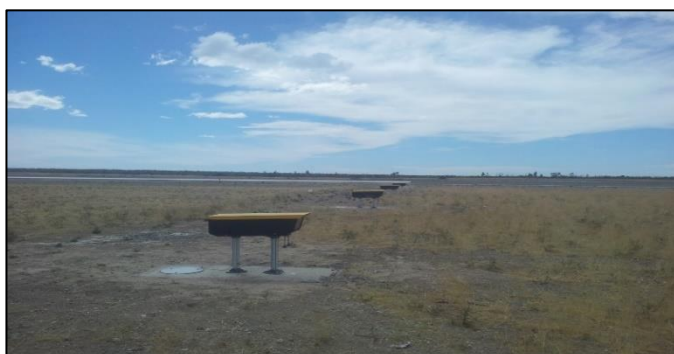
Luces de PAPI instaladas
