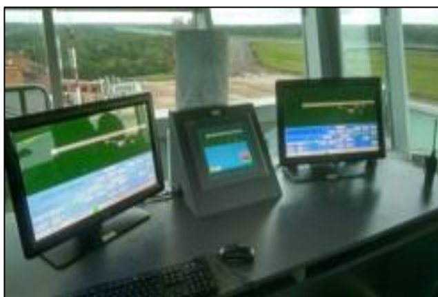
Sistema de Control
